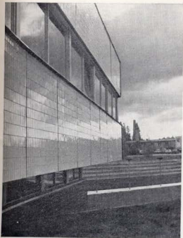
Фрагмент фасада. Стеновые панели облицованы глазурованной керамической плиткой белого цвета и синего цвета на первом этаже
