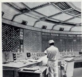
Ленинградская атомная электростанция. Общий вид, интерьер
