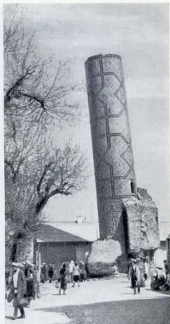
9 Северо-западный минарет. Осадка, уклон. [Контрфорс XIX в.]
