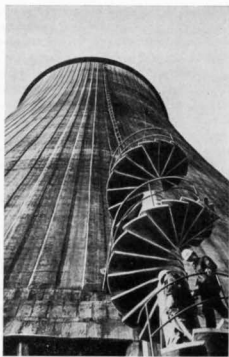
Боксберг. Электростанция большой мощности. Фрагмент
