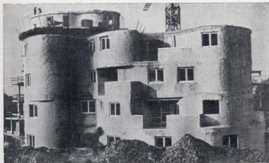
Строительство жилого дома в Алжере [Франция], 1975 г., архитекторы В. Калугин и С. Ванарски.
