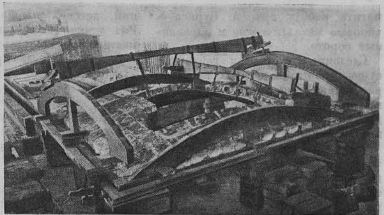
2. Вид кладки кирпичного сомкнуто-вспарушенного свода на стенде в лаборатории Главвоенпромстроя в Москве
