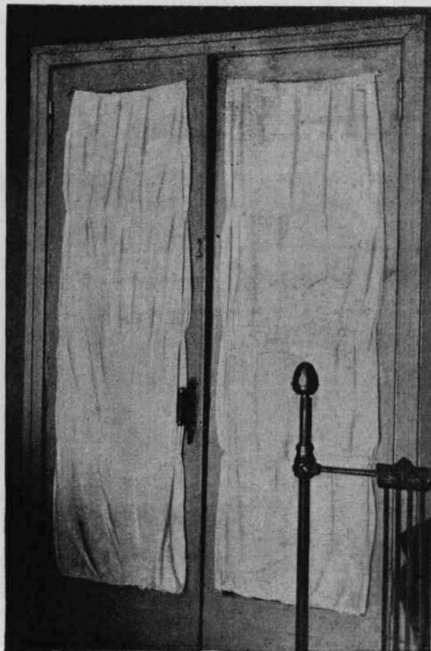
Деформация двери от усушки в новом доме на площади Земляного вала в Москве
