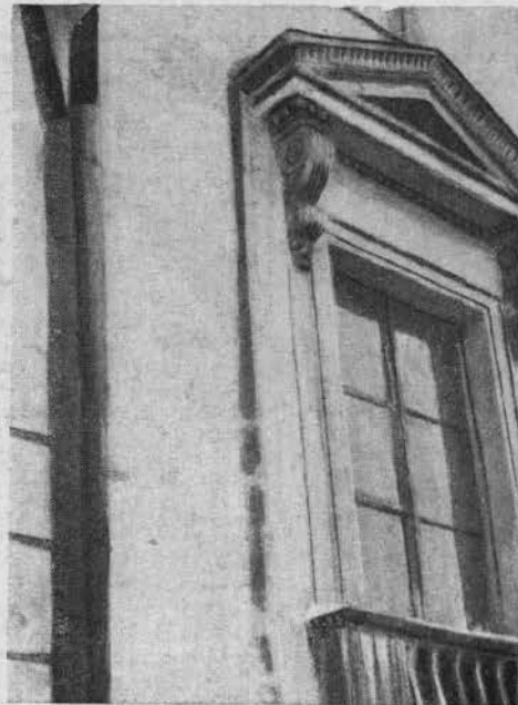
Грязевые потеки вследствие неправильного загиба (книзу) кровельного железа над оконным карнизом (жилой дом на Новинском бульваре)
