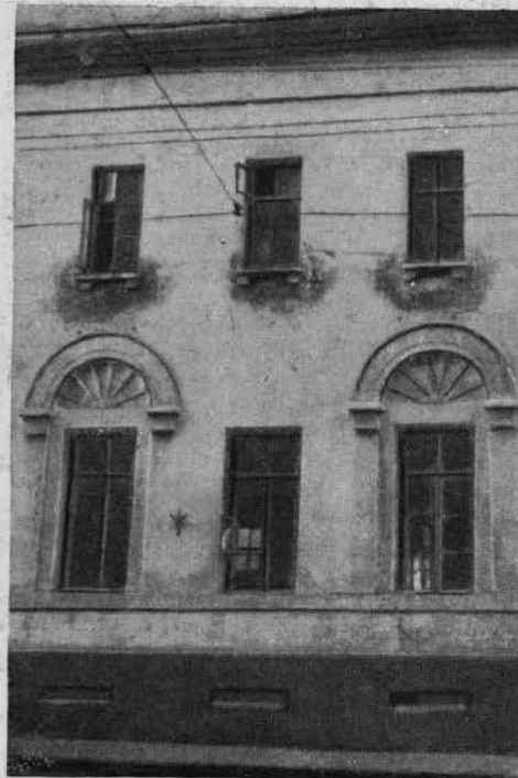
Инфильтрационные пятна на старом здании (дом на углу Б. Дмитровки и Страстного бульвара)
