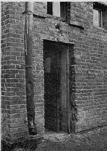
Дом научных работников б. Наркомснаба, Дмитровское шоссе Подлестничные клетки. Отсутствие отмета трубы. Незащищенная арматура электролампы. Быстрый износ дверной рамы из-за отсутствия площадки перед входом Дверная ручка разрушает штукатурку. Дверь заклеена объявлением. Наружная дверь сломана
