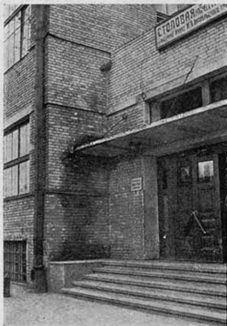
Фабрика-кухня № 1 в Москве Отсутствие водосточной трубы с крыши над входом Примыкание зонта к стене, при отсутствии водоотводящих устройств приводит к сырости и плесени
